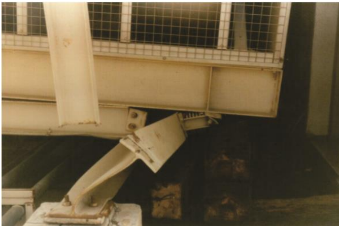
איור 6.4.1.3-3 - כשל במערכת תמיכה שלמה הכוללת מבודדי ויברציה.
