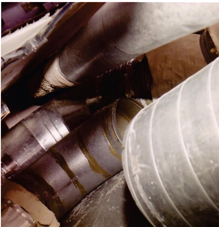
איור 6.4.6.1-1 – תעלה לא מעוגנת שהתפרקה לחלקים.
