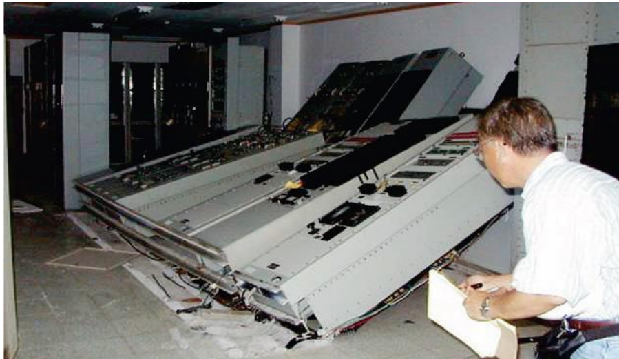
איור 6.4.7.1-1 – התהפכות ארונות חשמל. שימו לב למחסור בעיגון הארונות לרצפה.
