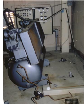
איור 6.4.1.3-1 – כשל בעיגון מדחס היושב על מבודדי ויברציה מסוג קפיצים.
