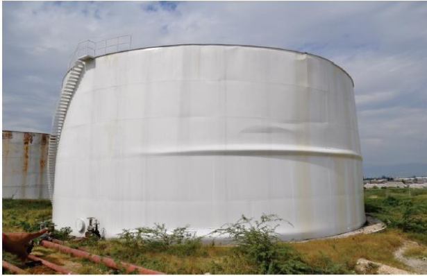
איור 6.4.2.2-3 - כשל בדופן מיכל.
