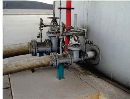
איור 6.4.2.2-5 - צנרת גמישה בחיבור עם המיכל מנעה נזק עקב רעידת אדמה.
