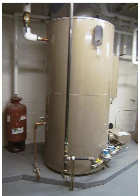
איור 6.4.2.4-5 – דוד מים בבית ספר מעוגן בבסיסו.
