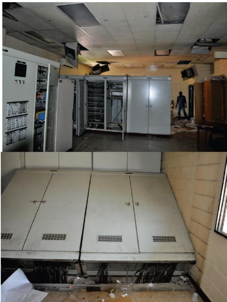
איור 3-6.4.7.1 – נזק שנגרם לארונות חשמל לא מעוגנים בתחנת כוח.
