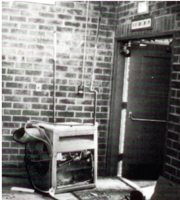
איור 6.4.1.6-1 – מערכת לחימום בגז שנפלה מהתקרה עקב רעידת אדמה.
