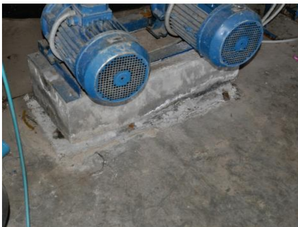
איור 6.4.1.1-2 - כשל בבסיס אליו עוגנו המשאבות.
